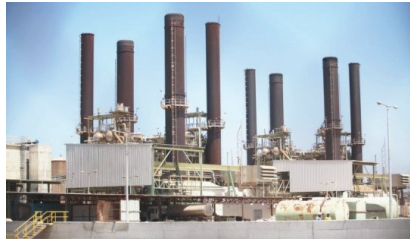
المولدات الكهربائية في محطة توليد الكهرباء في غزة
